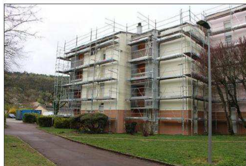
Les premiers échafaudages ont été mis en place. Au fur et à mesure, tous les bâtiments seront concernés par la rénovation extérieure et intérieure. Photo LBP/Ch. D.
