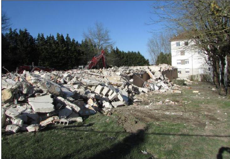
■ Le bloc B n'existe plus. Il faudra trier et déblayer les gravats. Photo Patrick MARCHAND
